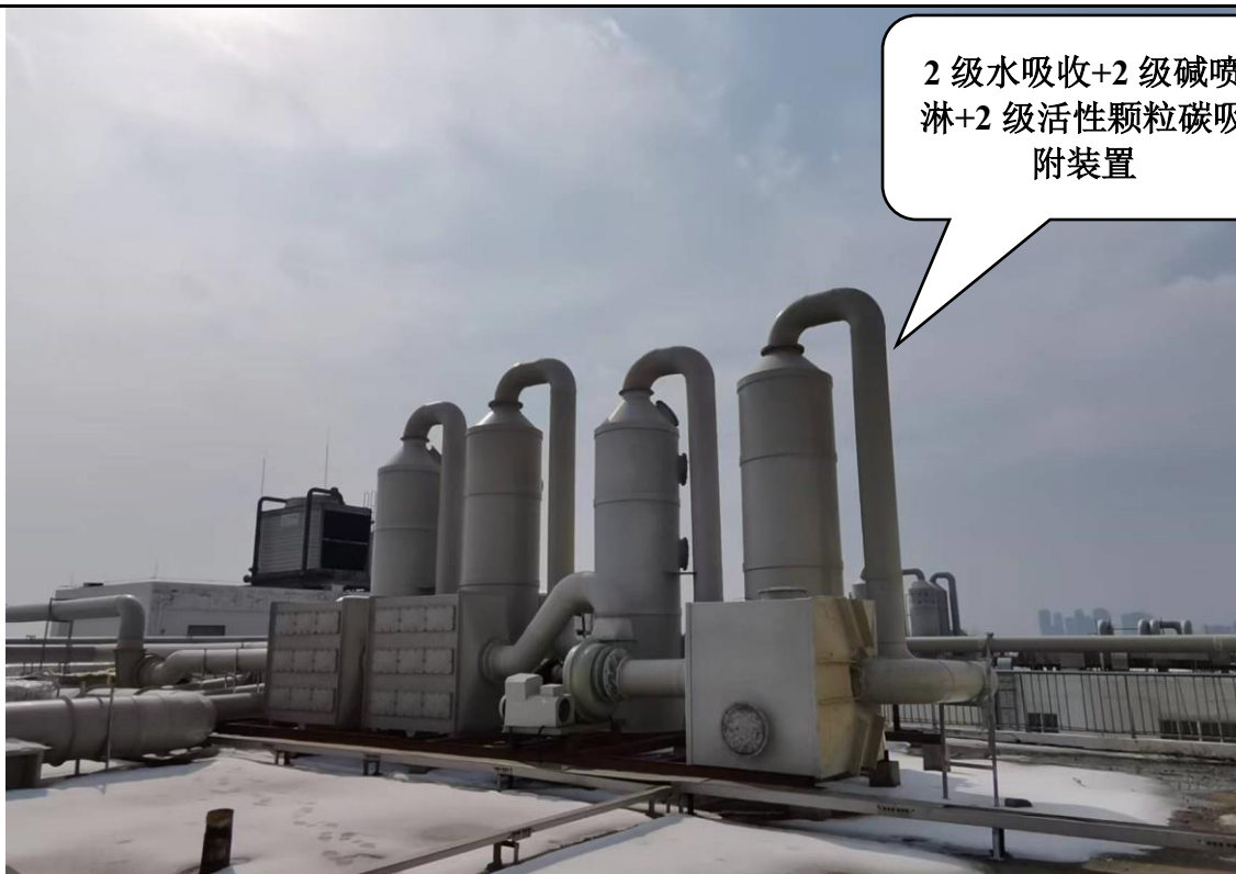
2级水吸收+2级碱喷淋+2级活性颗粒碳吸附装置（其二）
