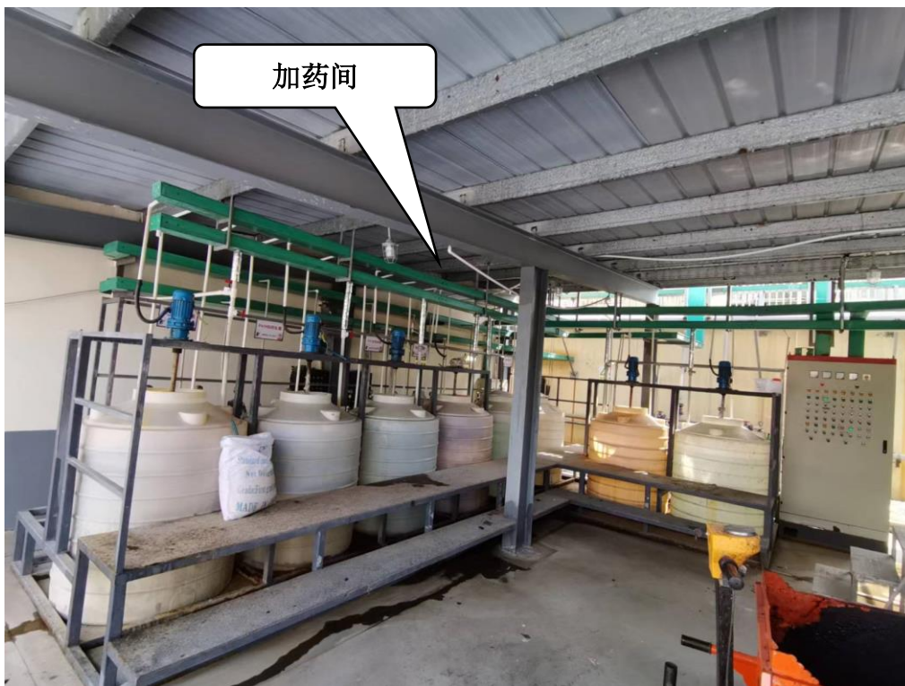
厂内污水处理站
