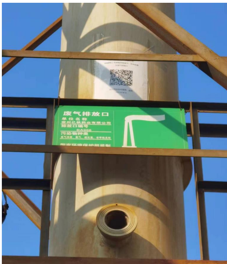
污水处理站、危废库废气排气筒标识牌（DA006）
