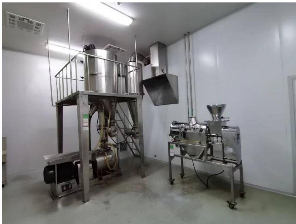
破碎粉尘布袋除尘设施
