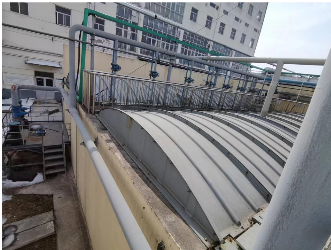
厂内污水处理站
