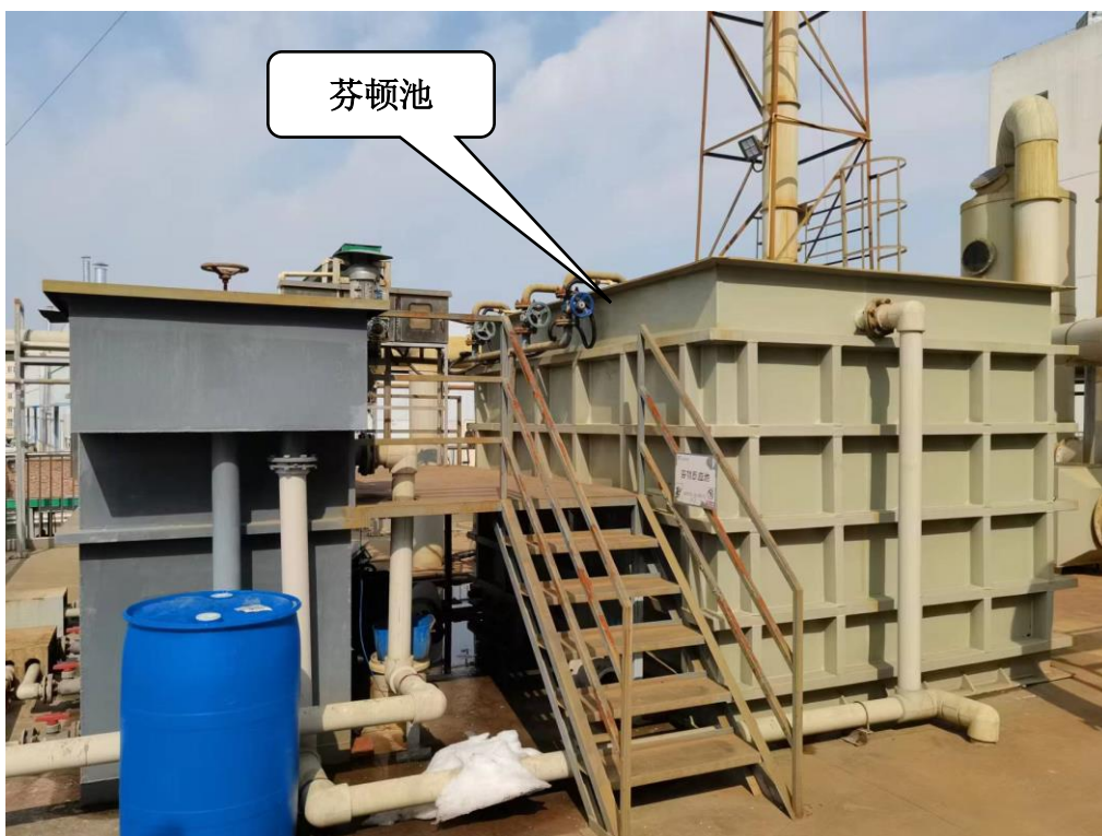
厂内污水处理站
